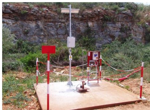
Stazione monitoraggio acque sotterranee in discarica
