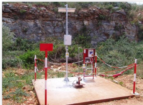
Stazione monitoraggio acque sotterranee in discarica
