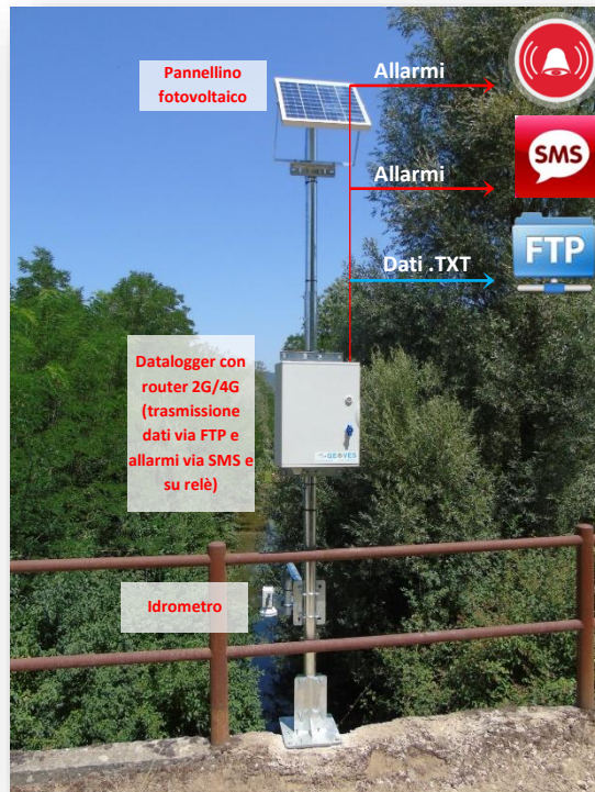
Stazione monitoraggio acque superficiali
