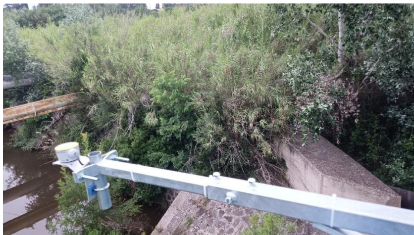
Figura 1 – Esempio di installazione di una stazione idrometrica con sensore radar
